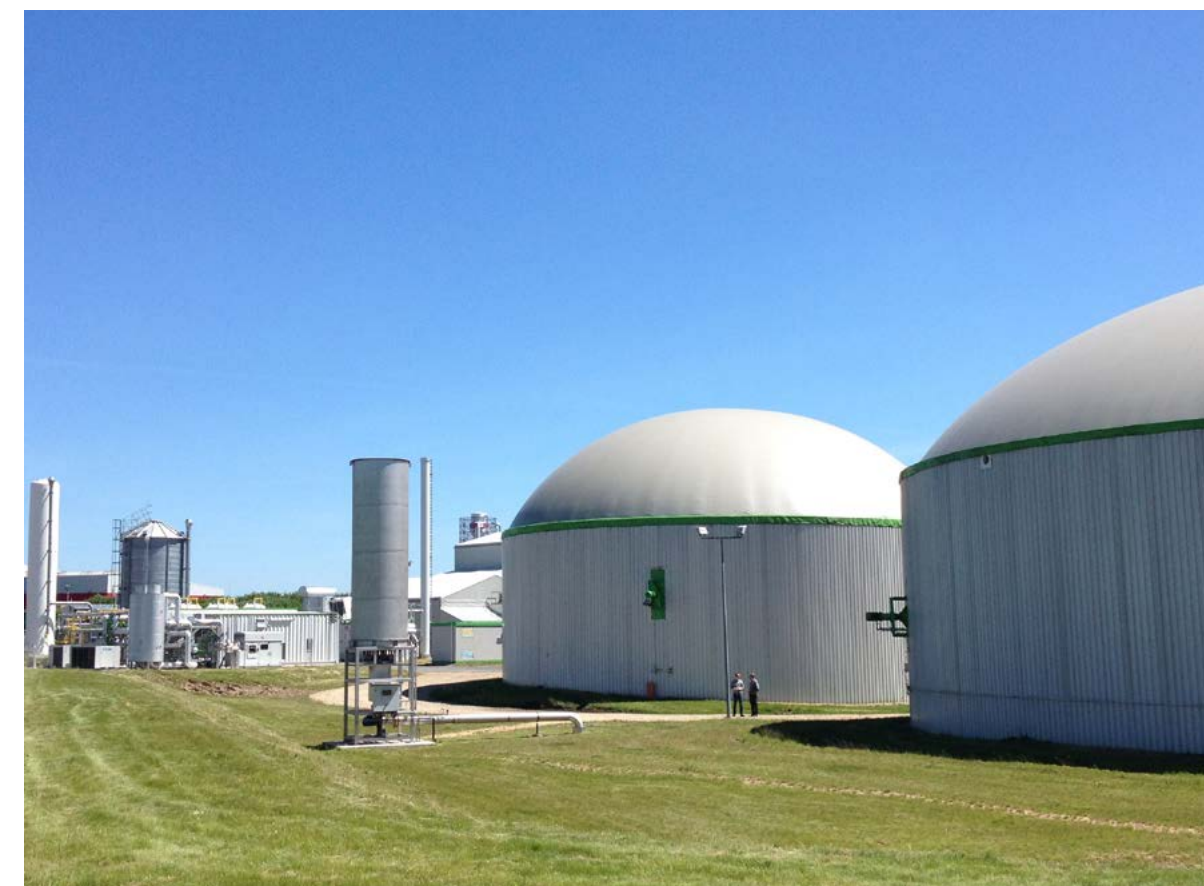
Unsere Biogasanlage in Kodersdorf kann bis zu 700 Nm 3 Biomethan pro Stunde in das Netz einspeisen.
